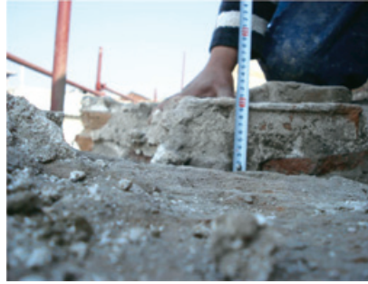
Resim 3. Duvarlarda 15cm'yi bulan kaymalar
