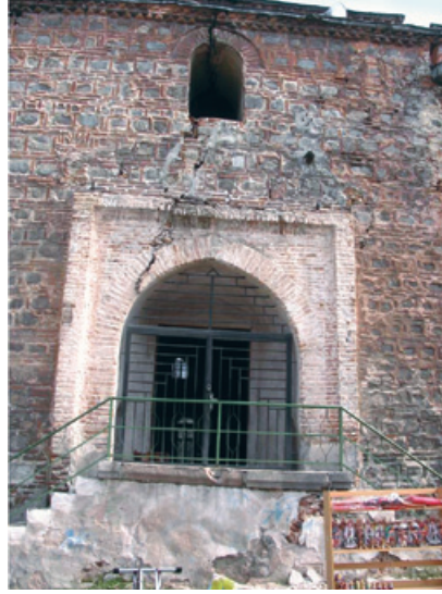
Resim 2. Depremlerden sonra oluşan yapısal çatlaklar
