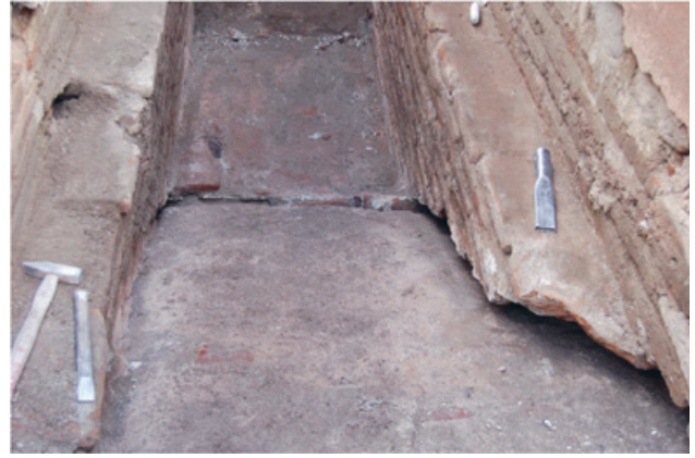
Resim 13. Kubbe ve tonozların arasında kalan derelerdeki çatlakların görünümü
