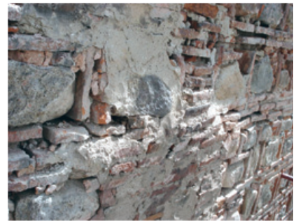
Resim 7. Derzlerdeki çimento katkıli eklentiler
