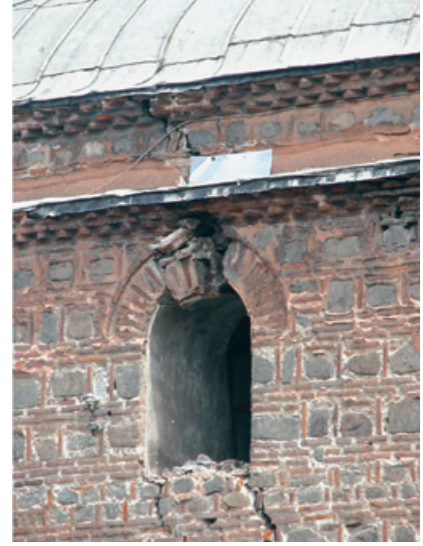
Resim 4. Yapısal bozulmaya yol açan kazılar sonucu oluşan çatlaklar
