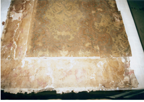
Resim 6. İkinci dönem duvar kağıdının hasarlı durumu ve üzerine kaplanmış üçüncü dönem duvar kağıdı
