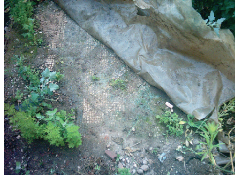
Resim 12. Naylon örtünün altında yoğun bitki oluşumu ve yatak harcından ayrılmış durumdaki mozaikler
