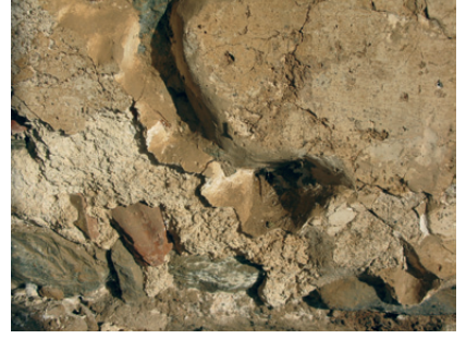
Resim 8. Onarımı yapılan duvarlardaki su ve tuz hareketine bağlı tahribat
