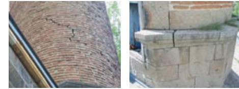
Şekil 9. Minarenin dış kısmında görülen makro çatlaklar
