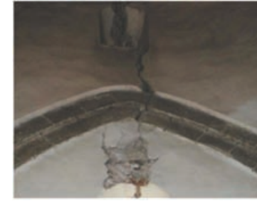
Şekil 7. Kemerlerin kilit taşı civarında meydana gelen hasar
