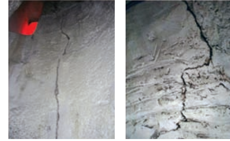
Şekil 8. Minarenin iç kısımlarında meydana gelen çatlaklar
