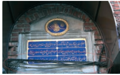
Şekil 50. Mimar Hayrettin Camisi'nin kitabesi ve tesisata ilişkin kabloların görünüşü
