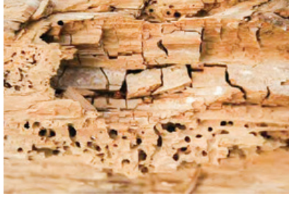
Şekil 3. Ahşapta esmer çürüklük mantarının yapmış olduğu bozunma ve odun delici böceklerin yapmış olduğu tahribat (Turner, 2008)
