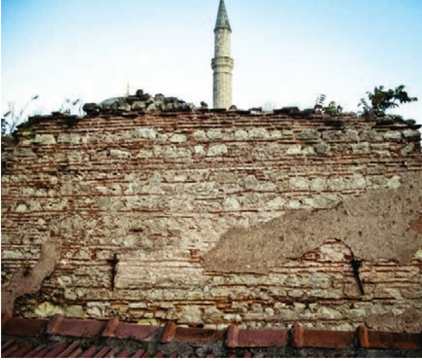
Şekil 10. Yapının kuzeybatı cephesinde dökülmeden kalmış olan sivalar
