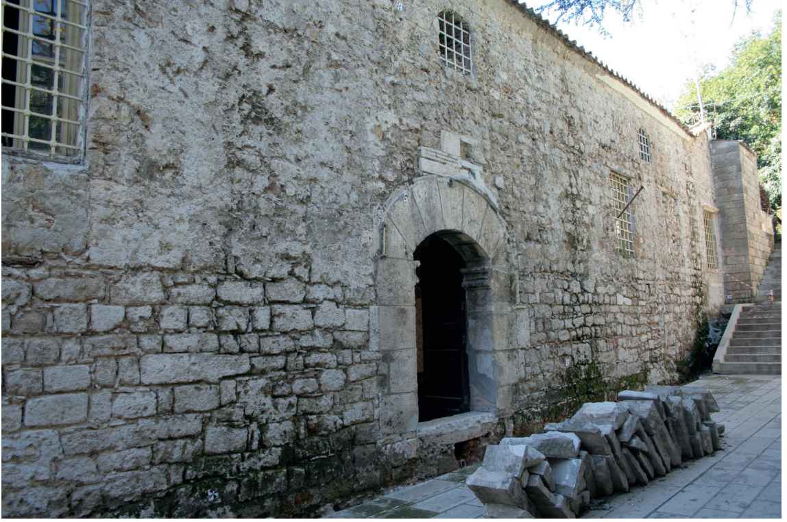
Şekil 08: Caminin Kuzey Cephesinde bulunan girişi ve eşik altındaki su künkü
