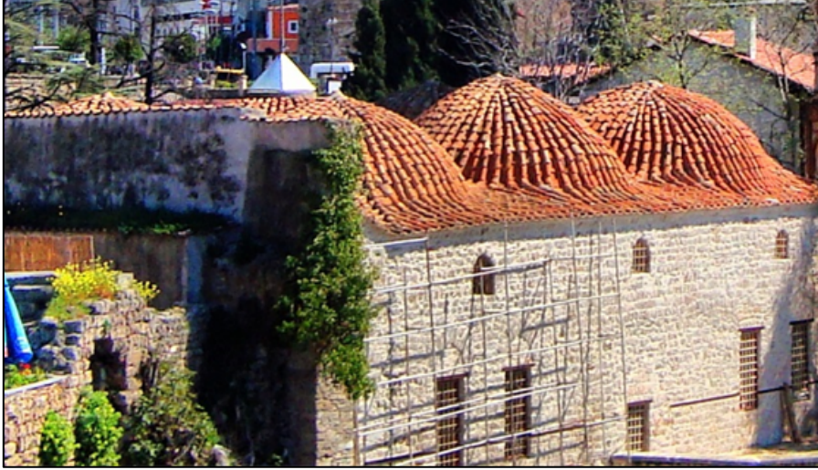
Resim 15. Yivli Minare Cami Bölümündeki Bitkisel Oluşumlar (Uzantı 2).
