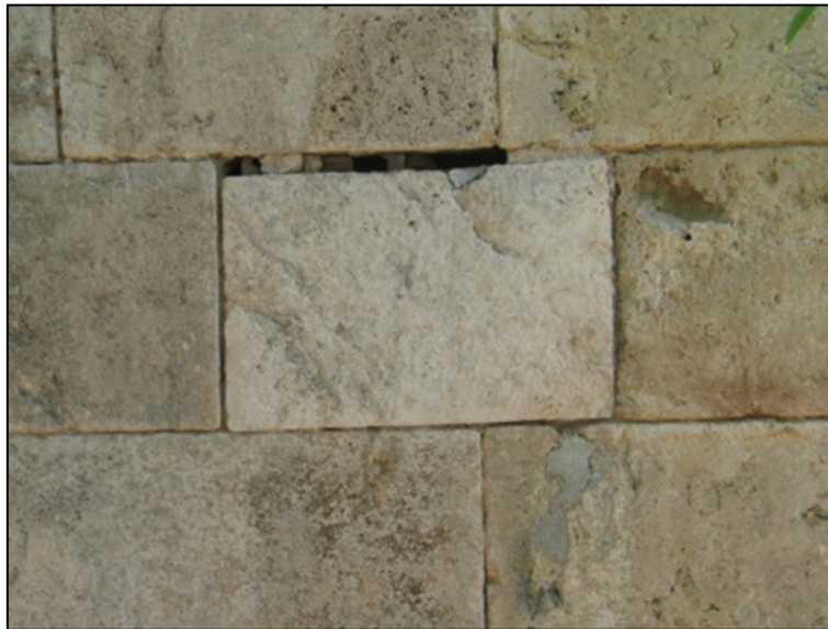
Resim 12. Yivli Minare Taş Duvar Bölümlerinde Derz Açılmaları ve Boşalmaları (Yazar Arşivinden).
