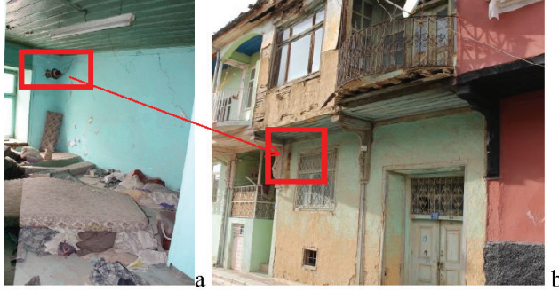
Şek. 15: 19 kapı numaralı evde baca deliği örnekleri, (a) oda-6'da bulunan baca deliğinin içeriden görünüşü, (b) oda-6'nın cepheden görünen baca deliği, kırmızı kutu içinde gösterilmiştir, 2018.
