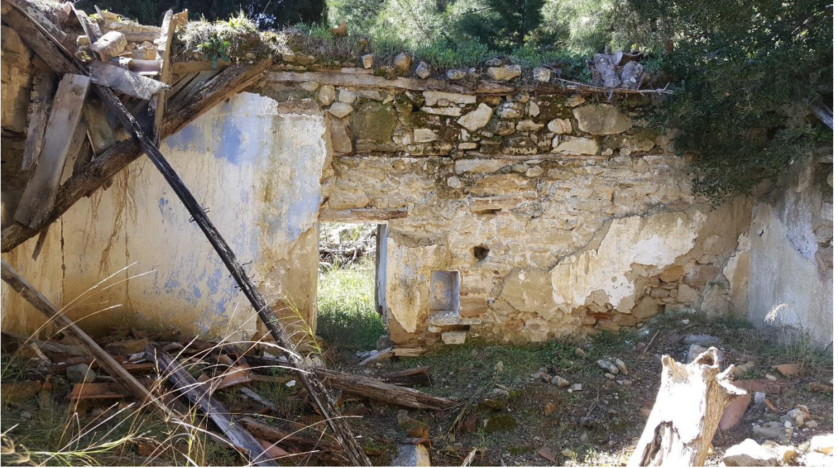
Türbe yapısının iç batı duvarı. Duvarın sağ tarafında 2011 senesinde mevcut olan süsleme, sıvaların dökülmüş olması nedeniyle artık görülmemektedir. Süsleme için bkz. EK 9.
