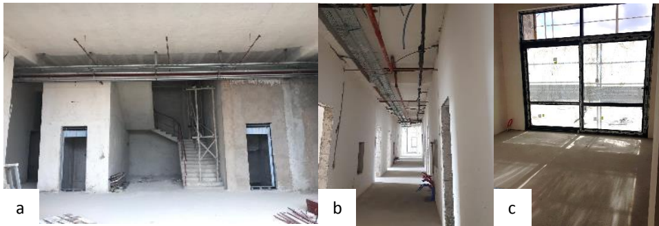
Şekil 10. Bina iç mekânı yapım süreci (a) Giriş Fuaye (b) Yatakhane Katı Koridoru (c) Tek Kişilik Oda (12.04.2019)
