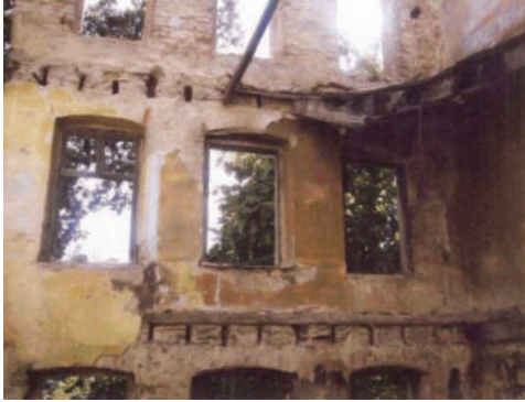
Fotoğraf 14. Yıkılan döşeme
