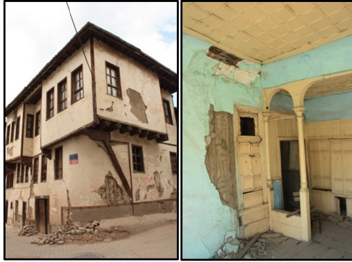
Şekil 26.-27. Cephe sıva ve iç duvar kaplaması bozulmaları / Bey Sokak (Yazar arşivi, 2013)
