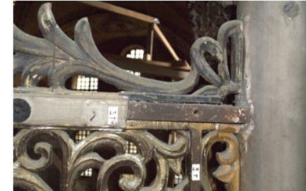
Resim 46, 6 Nolu Şebeke (6.15), demir gergi, korozyon.
