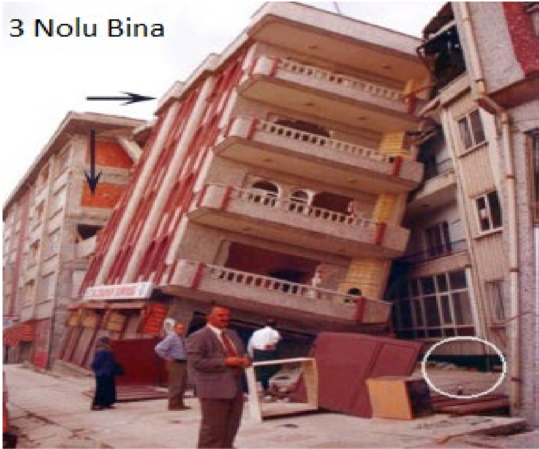
Şekil 7. Devrilen 3 Nolu Bina (Yükseklik:13.50 m, Genişlik:6.50 m), [1] (Overturned Building #3 (Height:13.50 m, Width:6.50 m))
