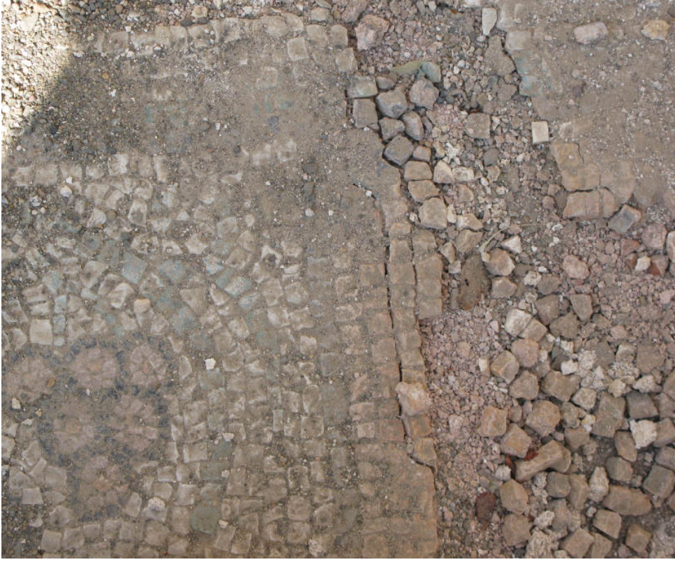
Fig. 7 Yeterli koruma önlemi alınmayan, periyodik kontrol ve bakımı yapılmayan taban mozağının tesseralarında dağılıma
