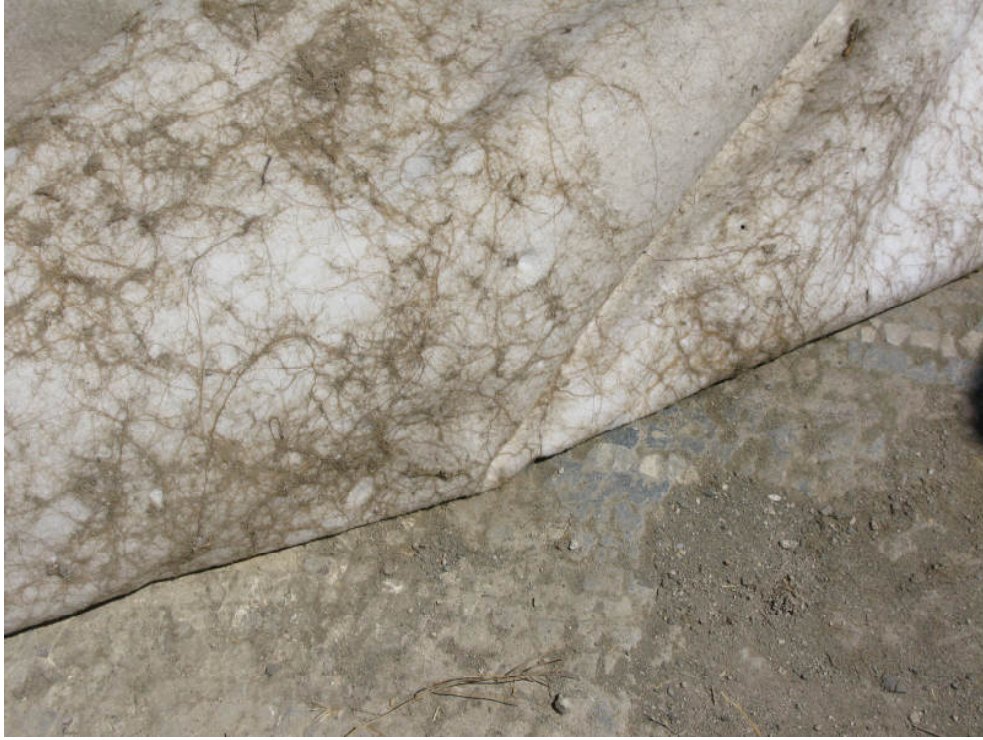
Fig. 10 Kontrol ve bakım eksikliđi nedeniyle geotekstil örtü altında oluşan bitki kökleri
