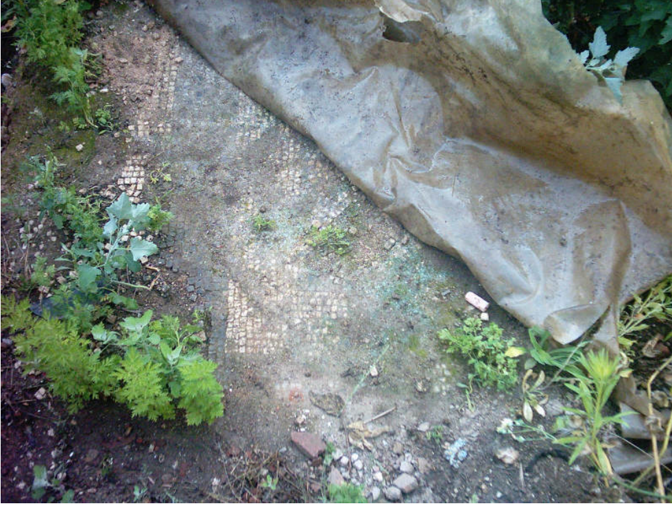
Fig. 11 Örtme işlemi için uygun olmayan bir malzeme olan naylon örtü altında yoğun bitki oluşumu ve yatak harcından ayrılmış durumdaki tesseralar
