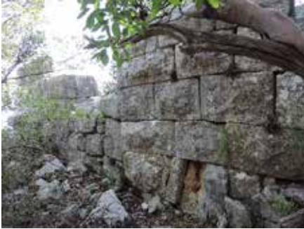
Abb. 50. Ostmauer des Gebäudes unmittelbar südlich von dem Bau mit Podium von Norosten
