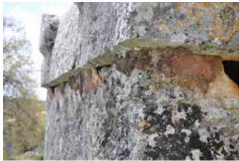
Abb. 103. Hyposorionsarkophag (HS2) die Reste von Mörtel mit rötlichen Ziegeleinschlüssen
