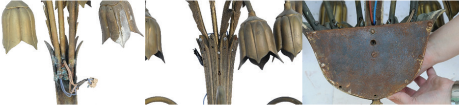
G. 4. Lale grubu apliklerde bozulma durumu; a) boru uçlarındaki oksitlenme ve lale kısmında boya kalıntısı (solda), b) aplik gövdesinde farklı boyutlardaki vidalar ve korozyon oluşumu (ortada), c) paraçolun taşıyıcı parçasında demir korozyonu (sağda) (M. Sağır, 2015)
