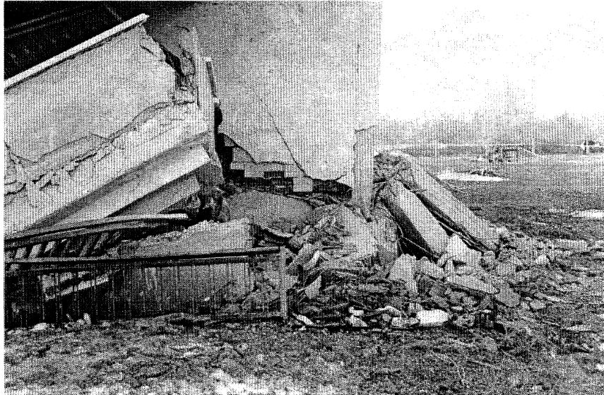
Resim-4. Konut Yapı Kooperatifi inşaatı odaki imalât hatası görüntüsü.
