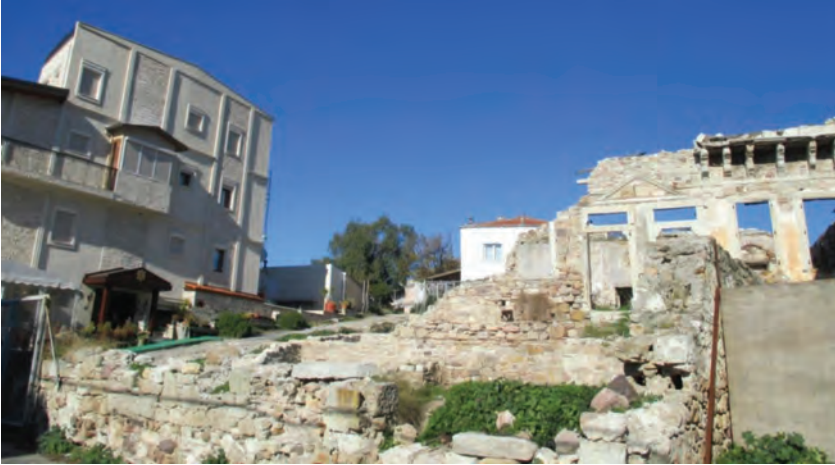
Resim 2. Kalıntıları üzerine otel yapılan Ağalar Konağı (Ç.K.A. 25)
