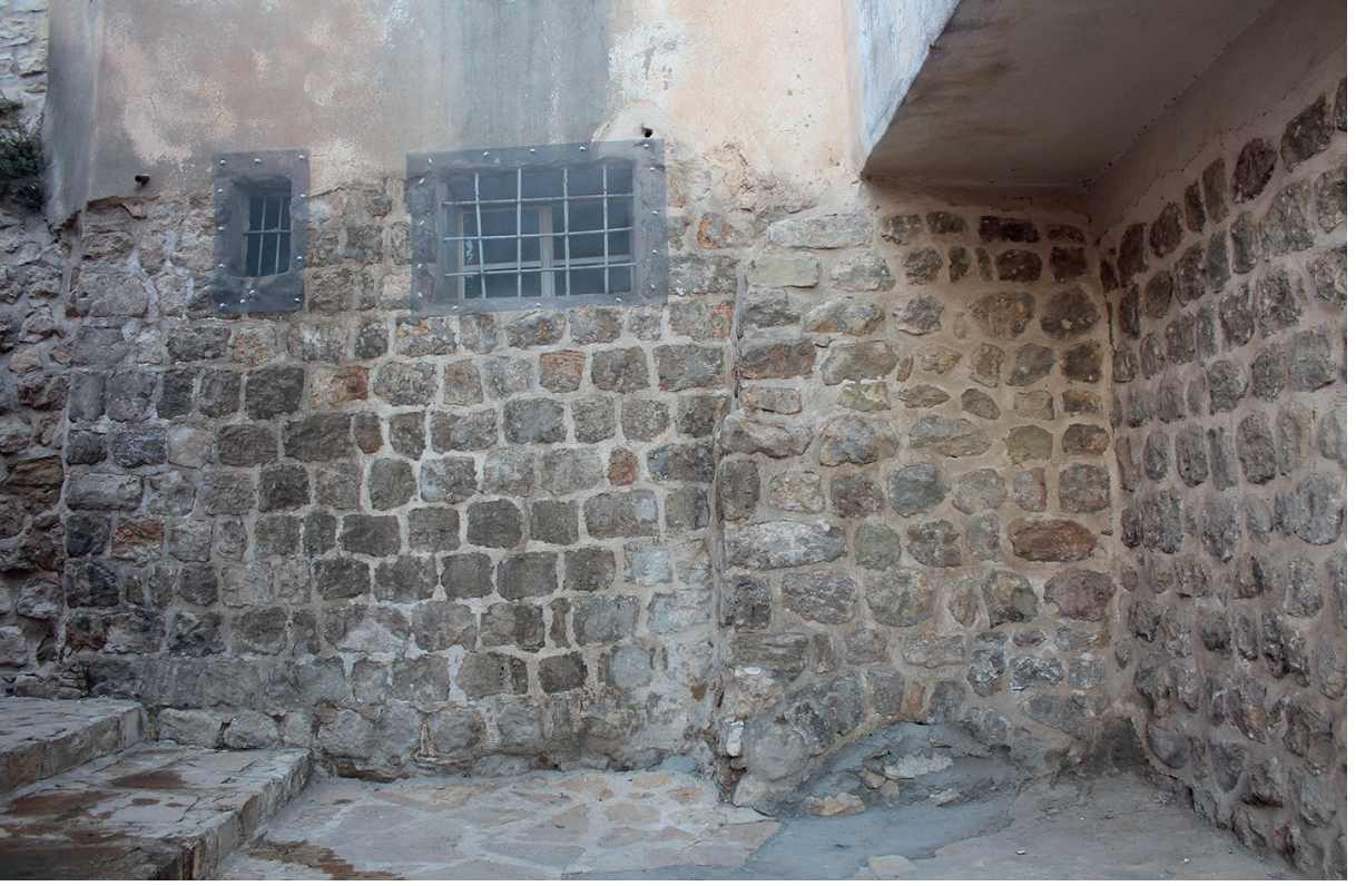
Resim 5 Şeyh Şeyhullah Camii. Kot Altında Kalmış Giriş Kapısı ve Islak Hacim Pencereleri, 2017.
