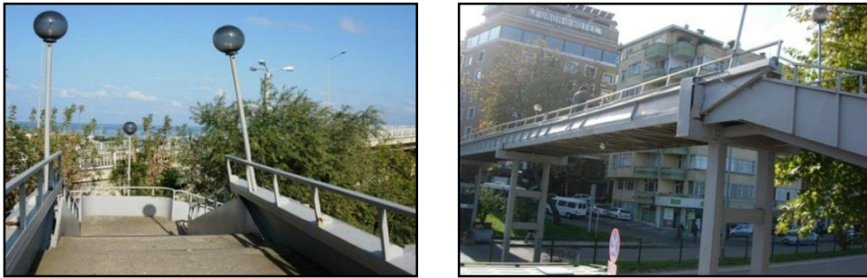
Şekil 21. Üst geçidin gördüğü tahribatın içten ve dıştan görünüşü Figure 21. Internal and external appearance of the upper passageway where the damage
