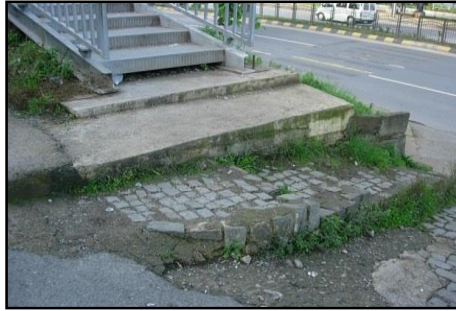
Şekil 16. Merdiven ve bağlantı sorunları Figure 16. Stairs and connection problems
