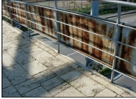
Şekil 12. Korkuluk yüzeyinden oluşan paslanma Figure 12. Surface rusted of banister
