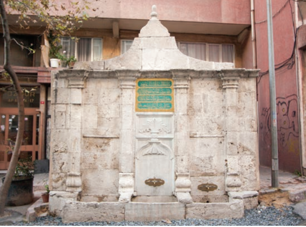
Şekil 18. İBB KUDEB tarafından 2009 yılında onarılan Sineperver Valide Sultan Çeşmesi'nde yapılan koruma uygulaması, önerilen Aktif / Mobilize Koruma Modeli kapsamında değerlendirilebilir. (Kaynak: KUDEB Taş Eğitim Atölyesi, 2009)
