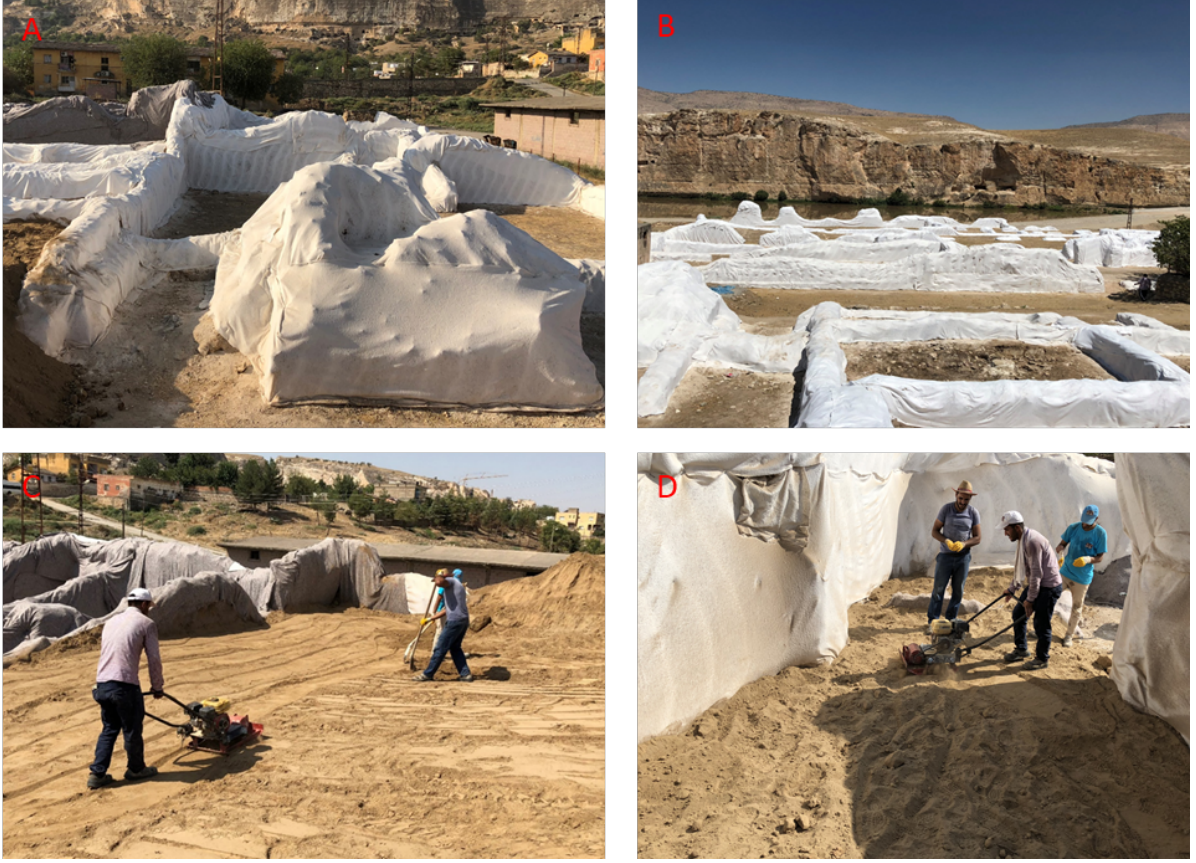
Resim 20. Mardinike Külliyesi Yapı Kalıntılarının Su Altında Korumasına Yönelik Uygulamaları, Resim 20A-20B: Jeotekstil Keçe Kalıntıların Yüzeyine İki Kat Olarak Serilmesi Uygulaması, Resim 20C-20D: Tabakalar Halinde Doldurulan Koruma Dolgu (Mil Kumu) Uygulaması (Yazar Arşivi)
