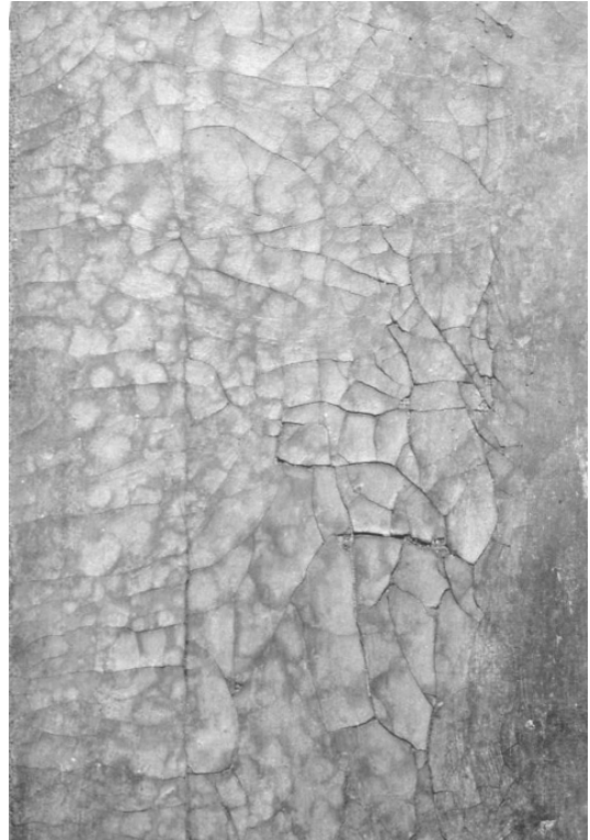
Resim 7: Eskime çatlakları detay çekim
