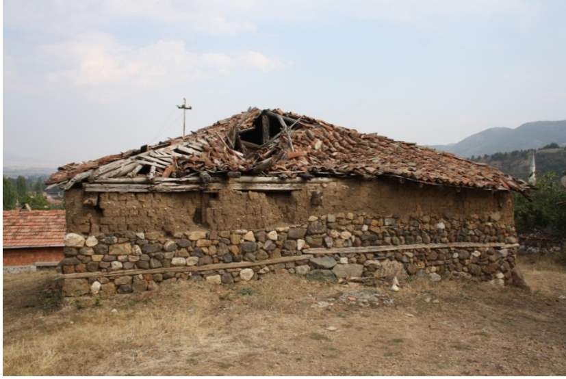
Fot.1 Mescidin batı cephesinden çökmüş çatının görünümü
