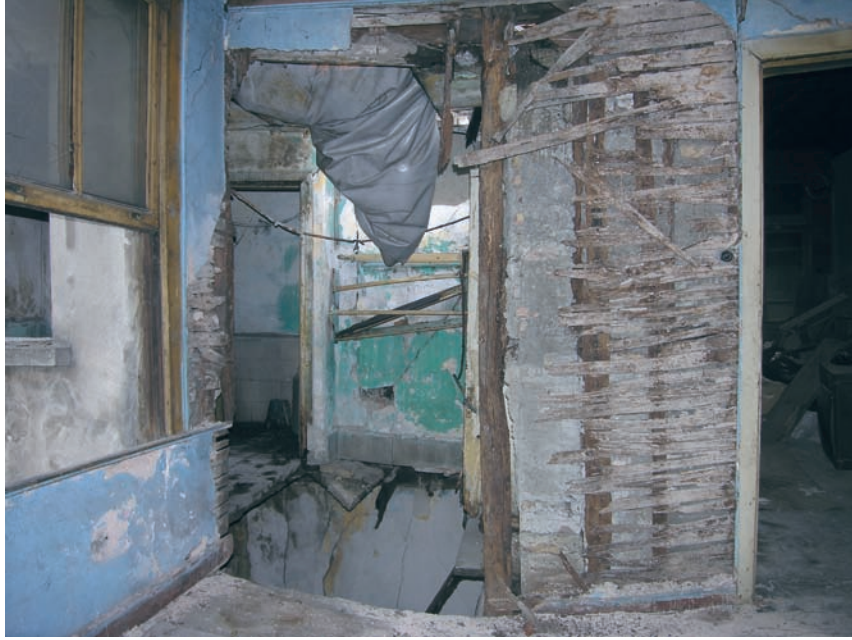
Şekil 3. İkinci kat, 2K04-2K05 mekanlarındaki yapısal hasar
