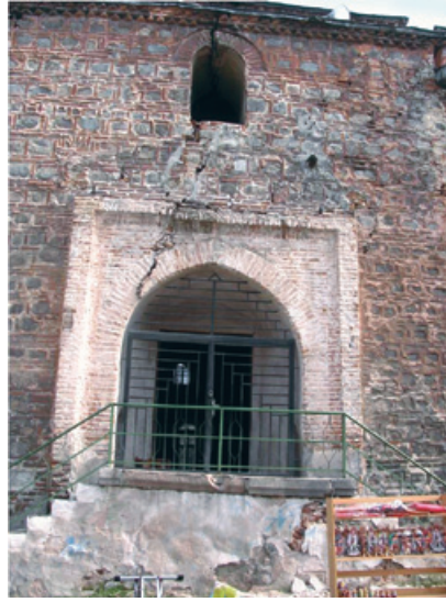
Resim 2. Depremlerden sonra oluşan yapısal çatlaklar
