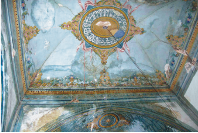
Resim 3. Restorasyon öncesi duvar resimlerinde oluşan yağmur suyu akıntıları
