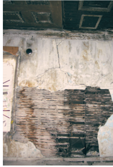
Şekil 10. 1.kat 1K03 nolu odada gözlenen deformasyon ve malzeme bozulmaları
