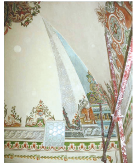
Resim 32. Caminin Kuzeydoğu Tonozu'nda yer alan duvar resmi katmanları
