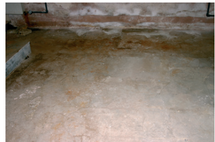
Resim 12. Dolmabahçe Sarayı, bodrum katındaki bir odanın duvarında oluşan yoğun tuz birikimi
