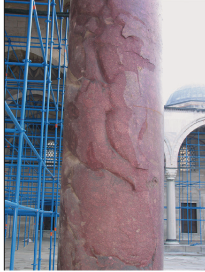
Şekil 32. Donma-çözünme etkisiyle eski kırmızı porfir sütunda oluşan çatlama ve dökülmeler
