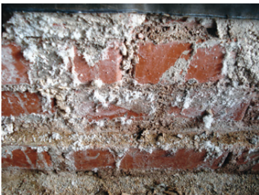
Resim 10. Dolmabahçe Sarayı- bodrum kat, tuğla yüzeyinde görülen tuz kristalizasyonu
