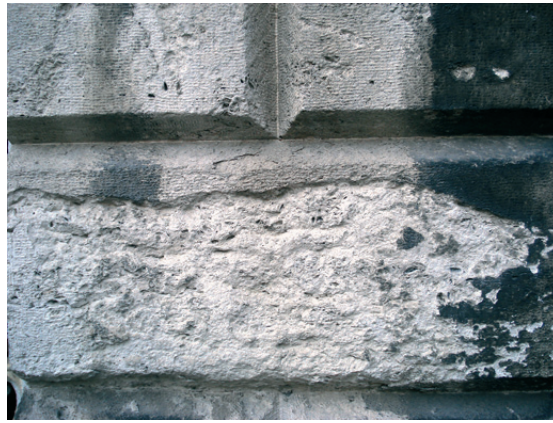
Resim 1-2. Dolmabahçe Sarayı, kireçtaşı yüzeylerinde alçıtaşı kabuk oluşumu
