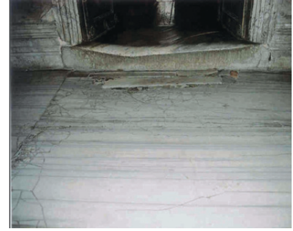
Şekil 33. Yer döşemesi olarak kullanılan Marmara mermerinde meydana gelen yüzey aşınması ve çatlamlar
