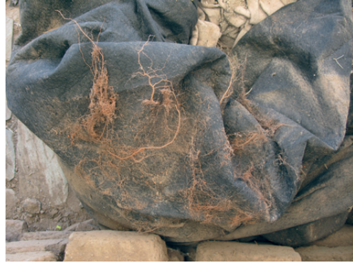
Resim 15. Geotekstil örtünün altındaki bitki kökleri
