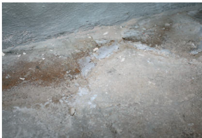
Resim 11. Dolmabahçe Sarayı, bodrum katındaki bir odanın zemininde oluşan tuz kristalizasyonu
