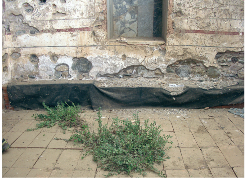
Resim 3. İyi projelendirilmemiş olan koruyucu çatı ve tabanda gerektiği gibi kullanılmamış olan geotekstil, alandaki su ve nem hareketlerine bağlı olarak gelişen bitki ve duvarlarda çözünür tuz kristallenmesi nedeniyle oluşan tahribatı engelleyememektedir.
