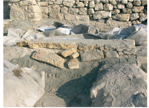
Resim 13. Geotekstil örtünün altındaki yapı taşlarının durumu
