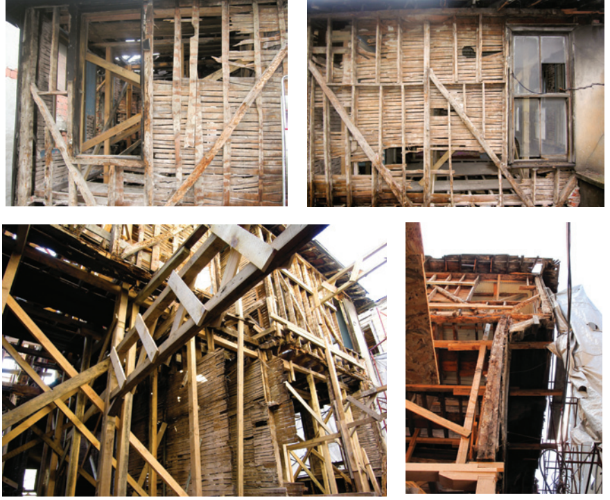
Resim 24. Yapının kuzey duvarının onarım öncesi durumu
