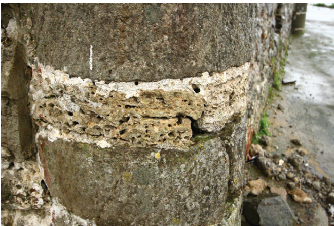
Şekil 6. Taş yüzeylerindeki çeşitli bozulmalar (KUDEB Rest. ve Kons. Lab., 2009-2011)
