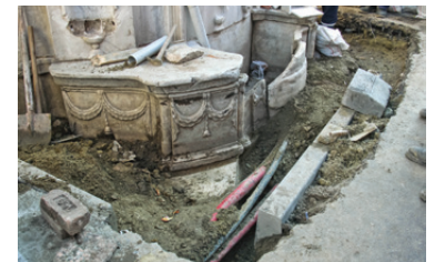
Çeşme önünden geçirilen şehir elektrik tesisatı
