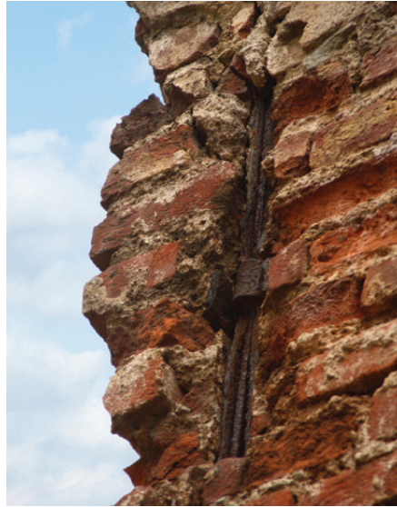
Şekil 12. Demir şebekede meydana gelen korozyon ve korozyon sonucu taşlarda meydana gelen bozulmalar (KUDEB Rest. ve Kons. Lab., 2012)
