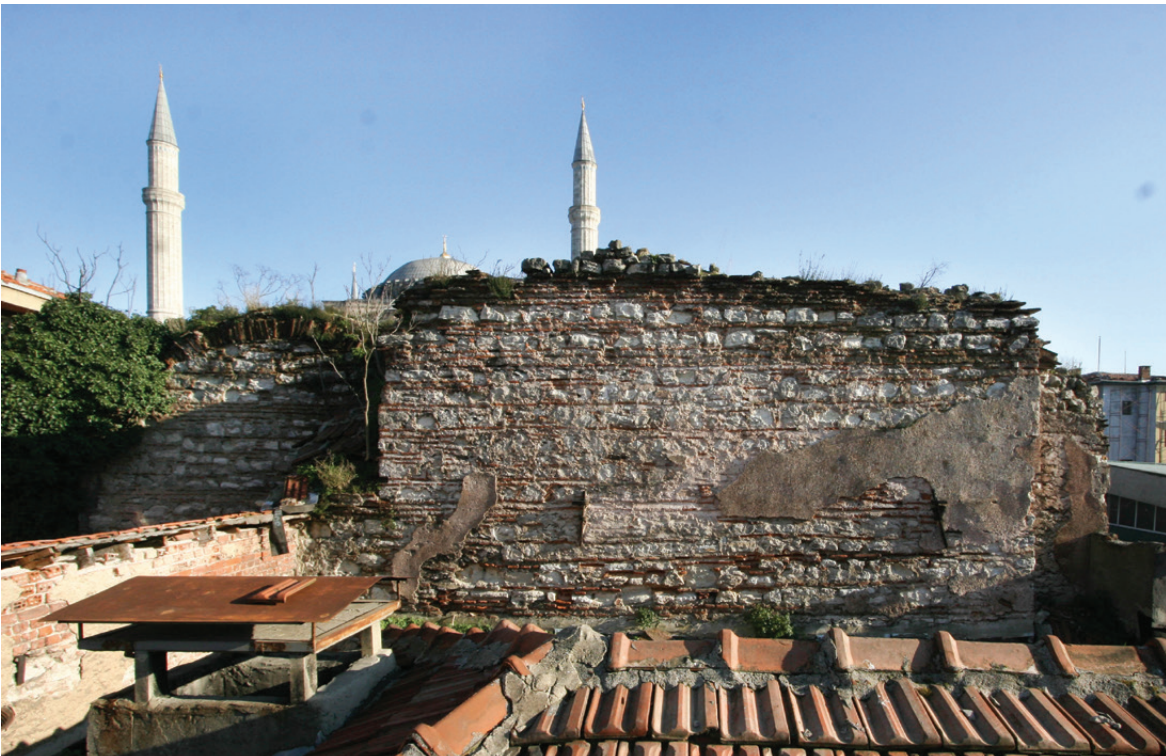
Şekil 12. Yapının Kuzeybatı cephesinde yer alan sıvalar
