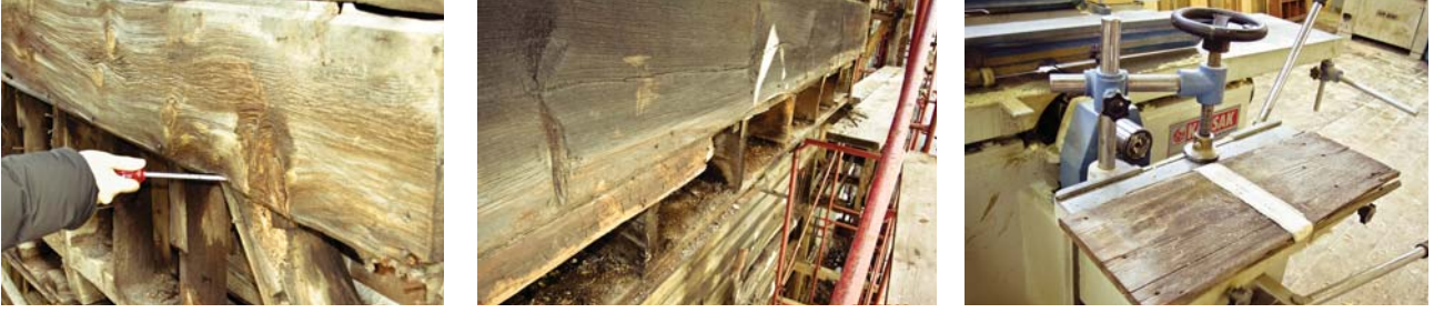
Resim 8. Cephe kaplama elemanlarının onarım öncesi durumları
