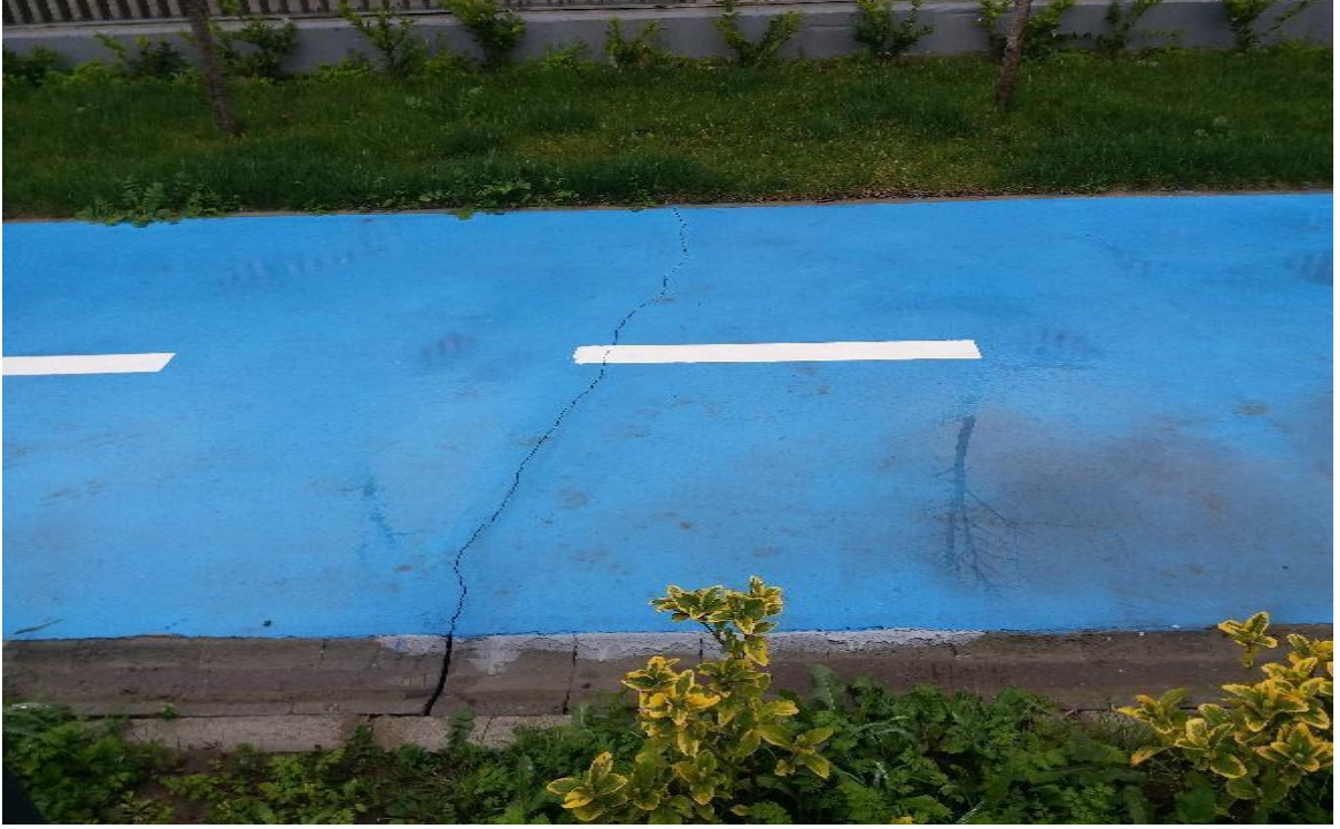
Şekil 9. Bisiklet Yolunda Oluşan Çatlaklar
