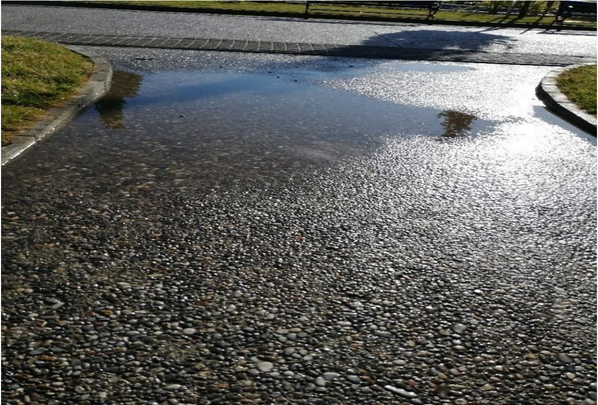
Şekil 10. Bahçe içerisinde su birikintileri
