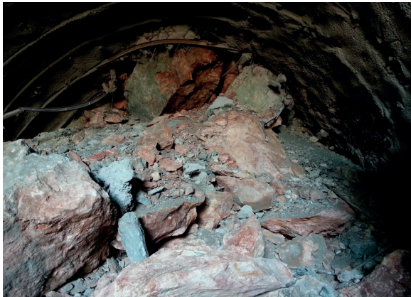
Şekil 3. Tünel içinde meydana gelen yenilmenin görünümü
