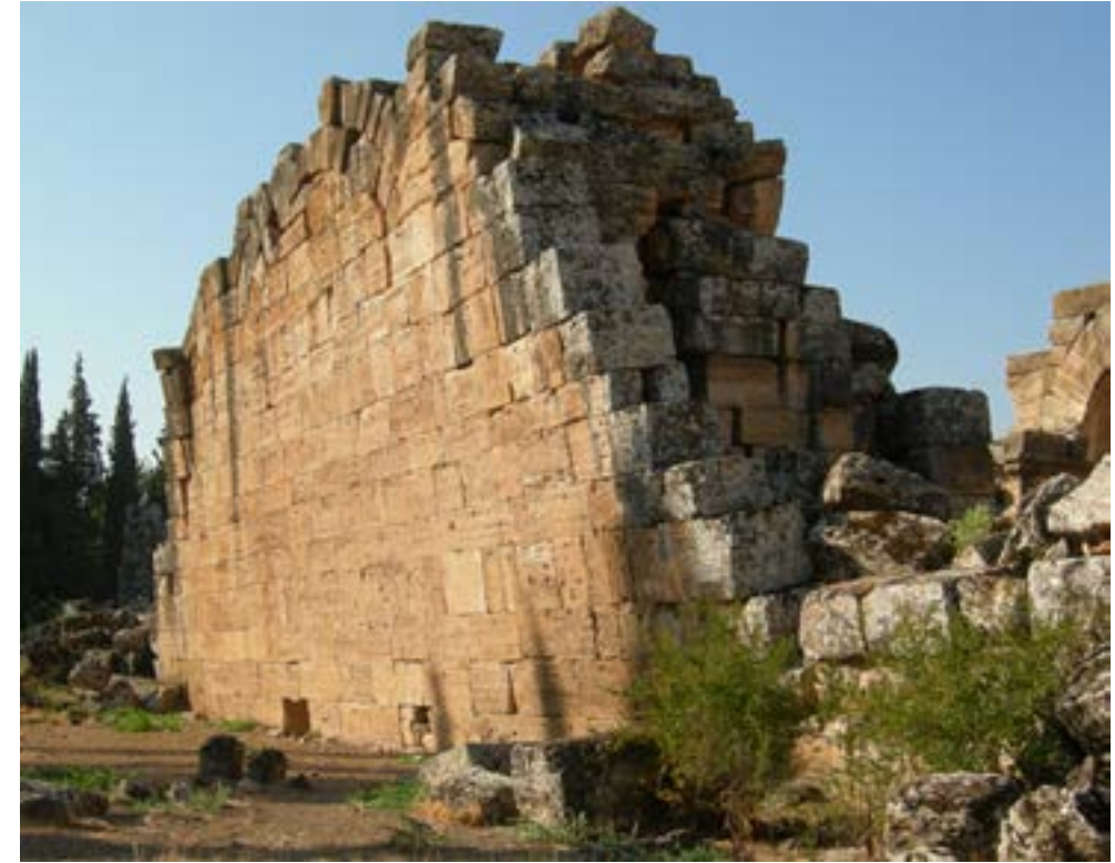
Fig. 1. Hamam-Kilise. Deprem nedeniyle eğimli hale gelen doğu duvarı.
