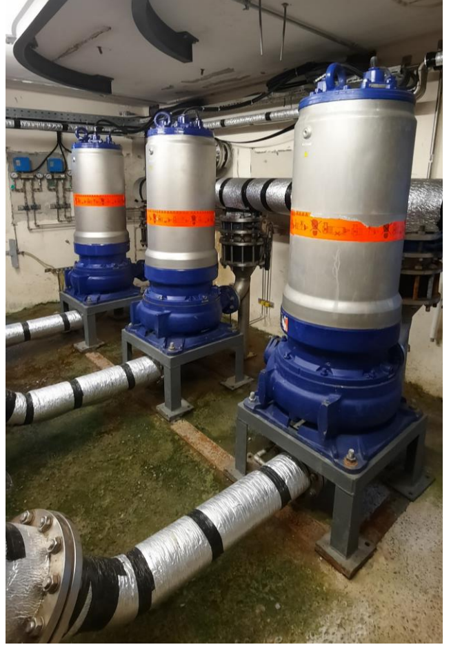
Şekil 17. Cevizlik HES soğutma suyu pompalar.
