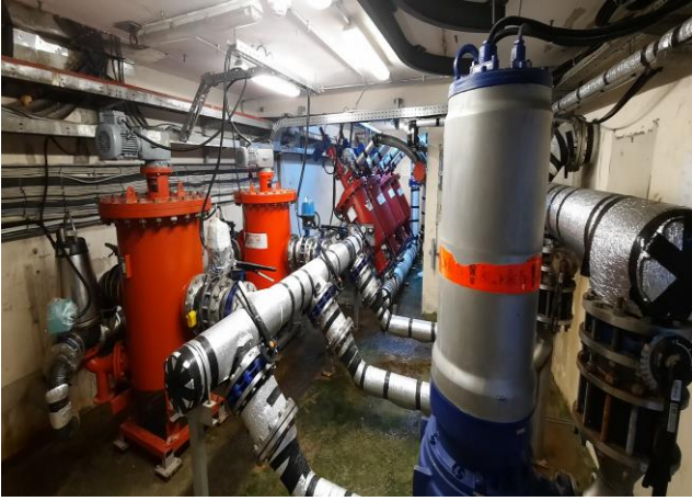
Şekil 15. Cevizlik HES kaba filtre ve pompalar genel görünüm.
