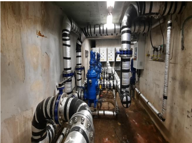
Şekil 16. Cevizlik HES ince filtre sistemi ve boru hattı genel görünüm.
