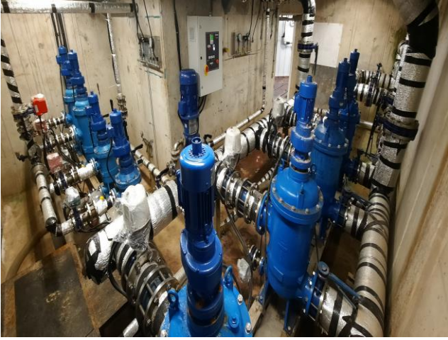
Şekil 14. Cevizlik HES ince filtre sistemi genel görünüm.
