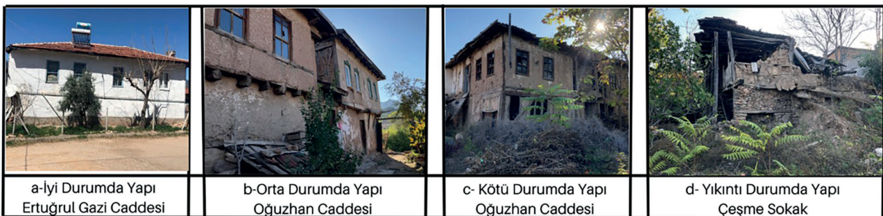
Levha 5. Yapısal durumlarına göre yapı örnekleri / Examples of buildings by their structural stability (Öztürk, 2022).
