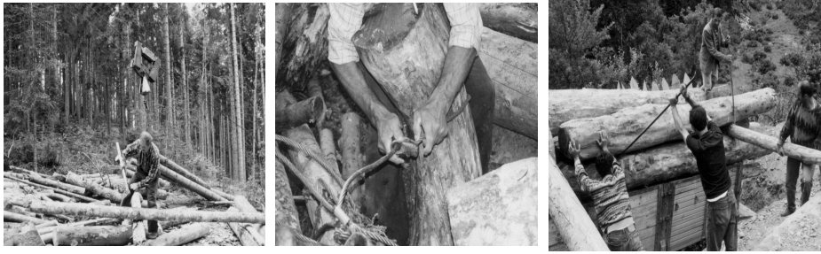
Şekil 5. Koruyucu Elbise ve Ekipman Kullanmadan Çalışan İşçiler
