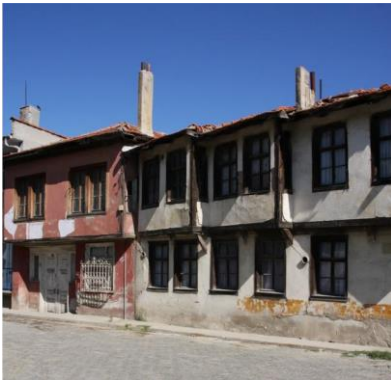
Şekil 32. Duvar boyunca devam eden düz ahşap ya- tay silmeler ve ahşap köşe dikmeleri (Solda 25 No'lu Konut, Sağda 13 No'lu Konut)
