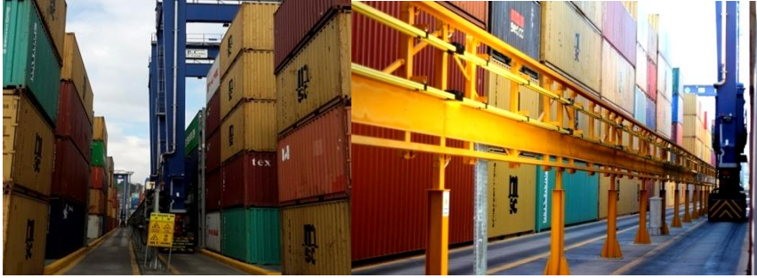
Şekil 2: E-RTG İçin Döşenen Baraların Görünümü Kaynak: Marport, 2015
