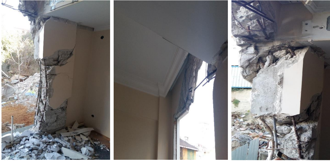
Şekil 1. Yapısal Hasarlar (Structural damages)
