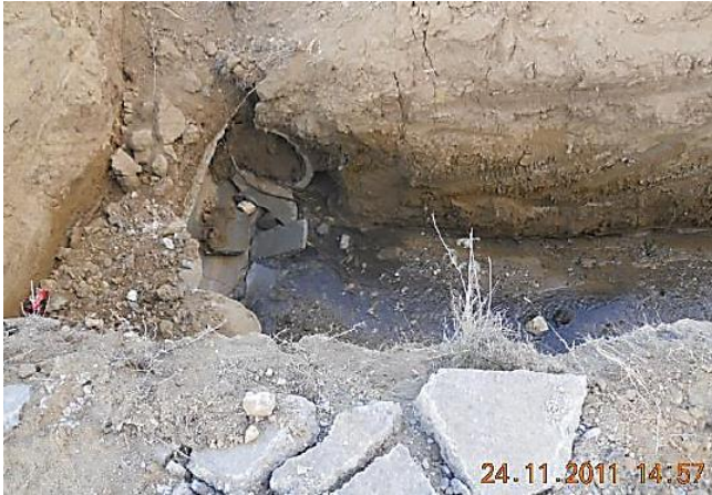
Şekil 3. OSB alanında görülen su kaçağı
