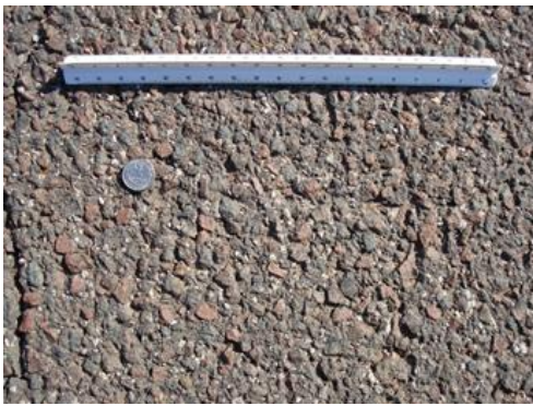
Şekil 1. Aşınma etkisindeki beton yüzeyi (Worn concrete surface) [2]
