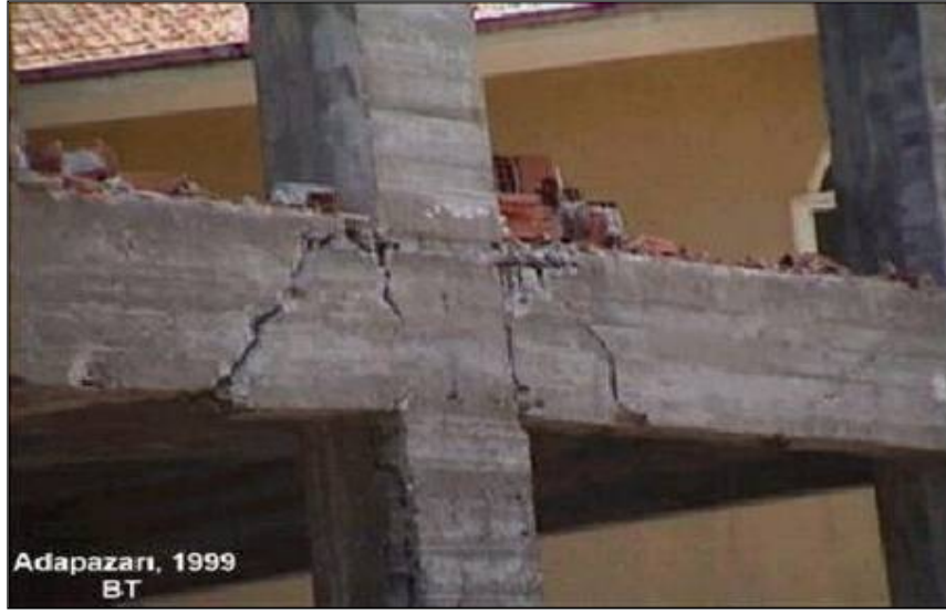
Şekil 20. Kirişte kesme kuvvetini karşılayacak sıklıkta etriye bulunmaması nedeniyle oluşan kesme kırıklıkları. Figure 20. Shear fracture due to the lack of the stirrup which compensates the shear force in a beam
