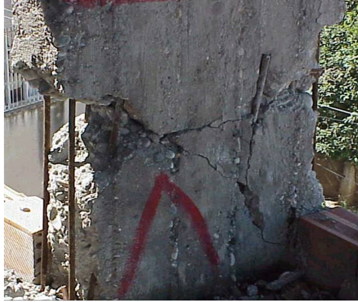
Şekil 18. Yeterli sıklıkta etriye kullanılmamış ve yetersiz işçilik nedeniyle oluşan kolon hasarları.
