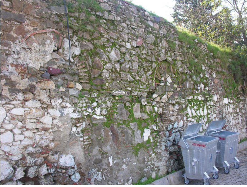
Fot. 13: Kuzey duvarı üzerindeki pencere izleri.
