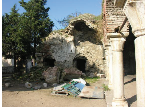
Fot. 9: Kısa kanat üzerindeki yıkılmış kubbeler.
