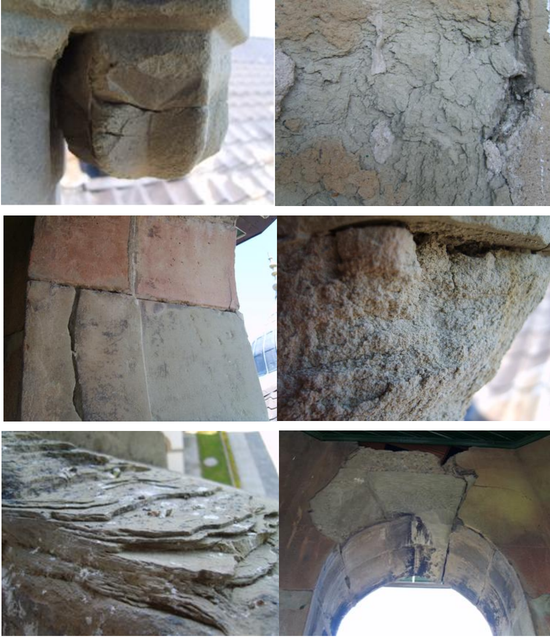
Şekil 3. Kumtaşlarındaki bozulma görüntüleri [7]
