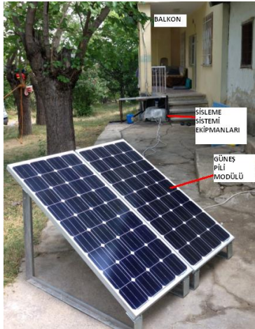
Şekil 4. Balkon serinletilmesi sistemi (Balcony misting system)
