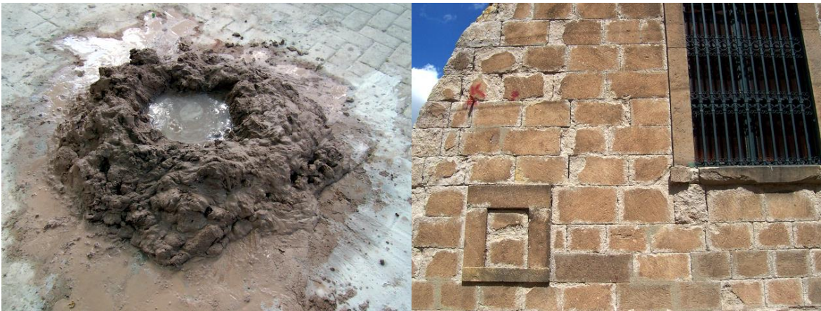
Şekil 7: Derz dolgusu ve bütünlemede kullanılan harçlar ve derz dolgularını görünümü. (The view of joint filler used in the grouting process)
