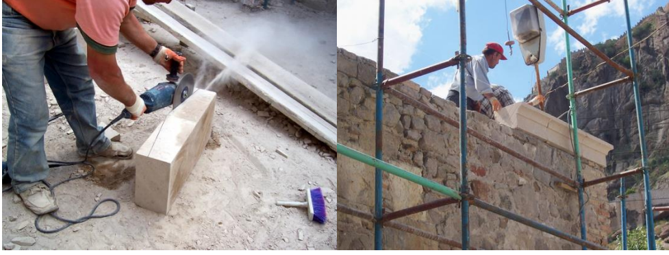
Şekil 5. Mevlevi (Türbe) Cami restorasyonunda bozmuş harpuştaların yenilenmesinin görünümü (Restoration of capstones in Mevlevi (Turbe) Mosque).
