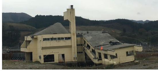
(b) Enkazı Yerde Bırakılan Betonarme Bina
