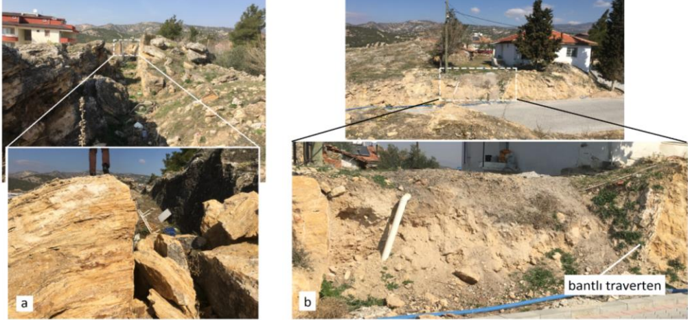
Şekil 6. a: Karahayıt batısındaki açılma çatlağının uzak ve yakın görünümü (kuzeye bakış)., b: Karahayıt batısındaki açılma çatlağının kuzeye devamı ve bantlı travertenlerin uzak ve yakın görüntüleri (kuzeye bakış).
