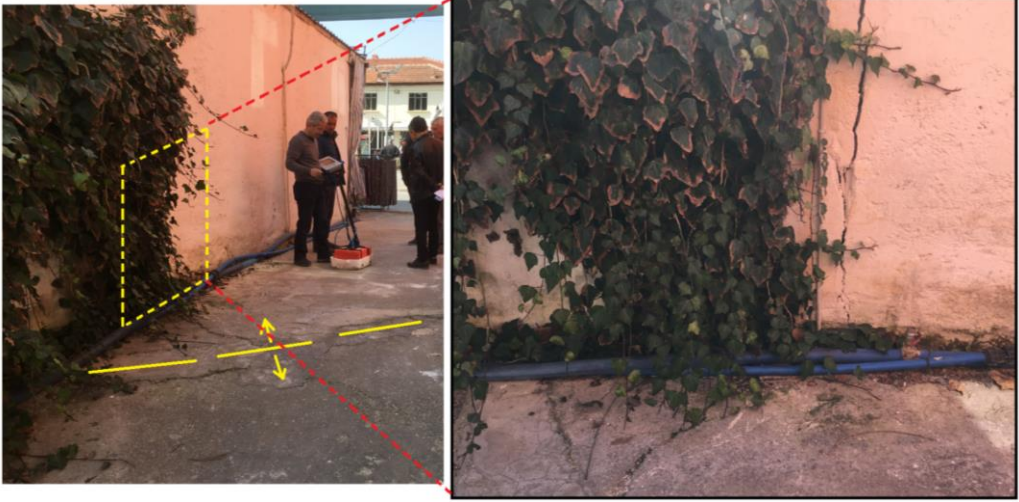
Şekil 10. Ara sokak içerisinde 24 nolu ölçüm güzergahı ile çatlağın genel konumu (batıya bakış) ve güney duvardaki açılma (güneye bakış).
