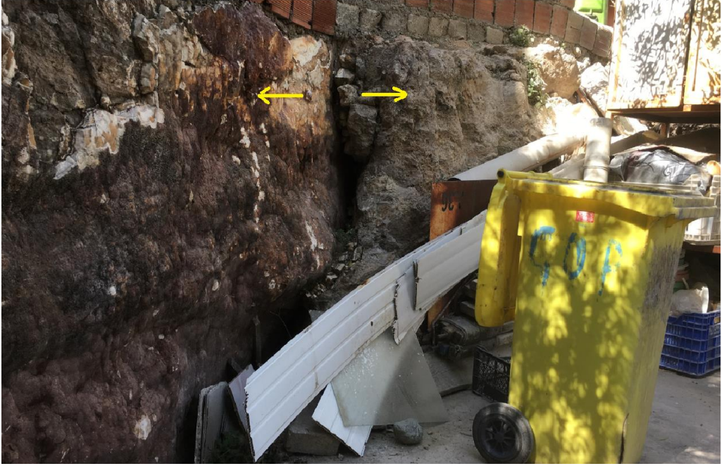
Şekil 11. 124 nolu sokakta gözlenen çatlak yüzeyi (kuzeye bakış).
