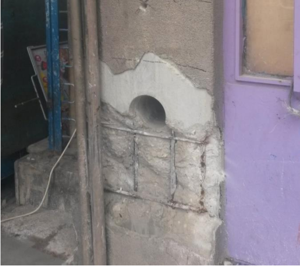
Şekil 4. Beton numunesi alınmış ve sıyırma yöntemiyle donatı tespiti yapılmış taşıyıcı eleman
