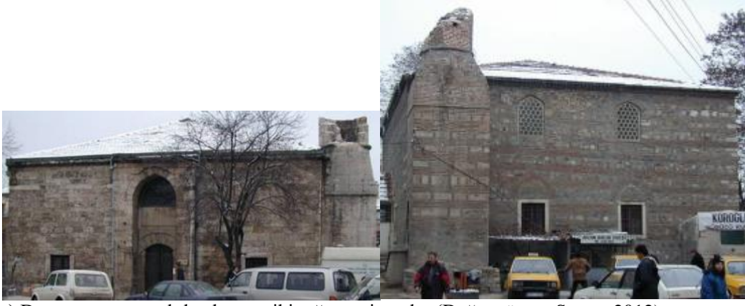
a) Deprem sonrası yıkılan bazı tarihi yığma minareler (Doğangün ve Sezen, 2012).
